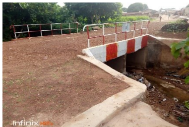
Le pont de Sakabanssi reliant Nikki et Kalalé au nord du Bénin © DDC Benin
